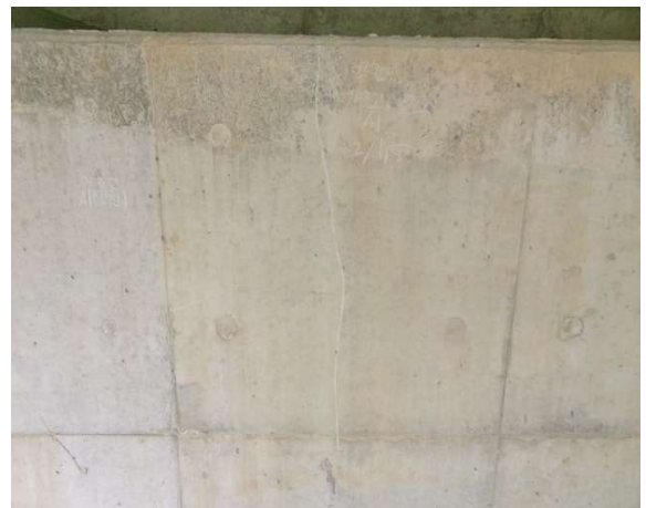
위 치 교대 영천방향 A1 현 황 균열 (Cw<0.3mm)
