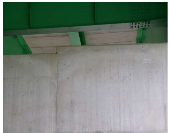
위 치 교각 영천방향 P2 현 황 균열 (Cw<0.3mm)
