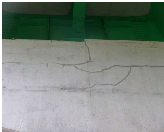
위 치 교각 상주방향 P1 현 황 망상균열 (A=7.0m×1.5m)
