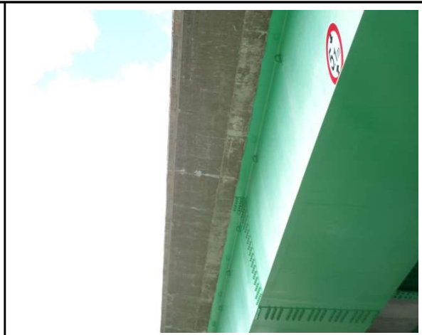
위 치 바닥판하면 영천방향 S2 현 황 균열부백태 (A=0.2m×1.0m×2EA)
