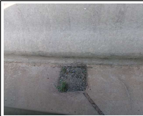
위 치 배수시설 상주방향 S3 현 황 배수구 막힘
